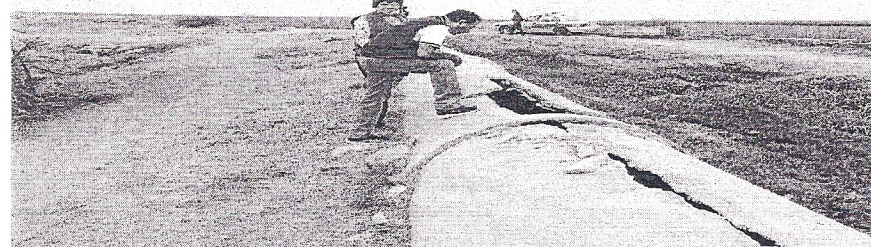
Figura 5: Tubo Colector deteriorado
